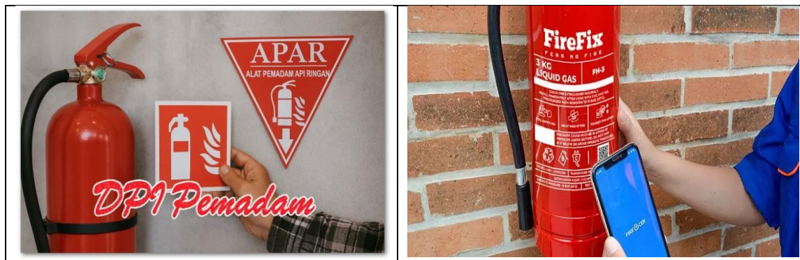
Gambar 9. Foto penempatan apar & rambu keselamatan
