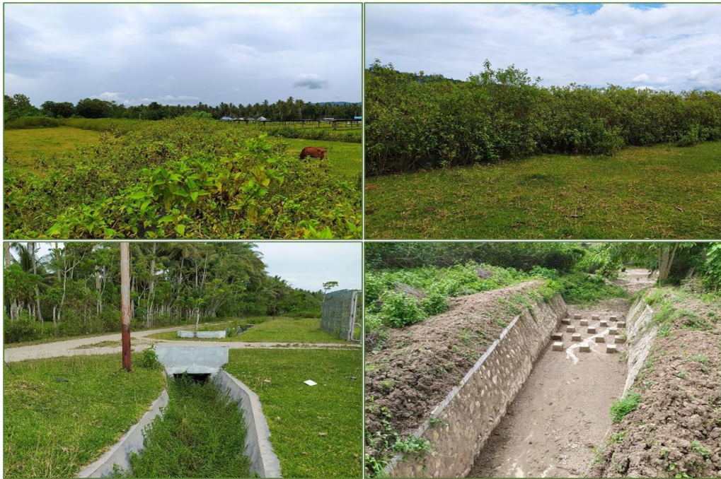
Gambar 3. Kondisi Pengendali Banjir dan Saluran Drainase di Areal PLTS Isimu
